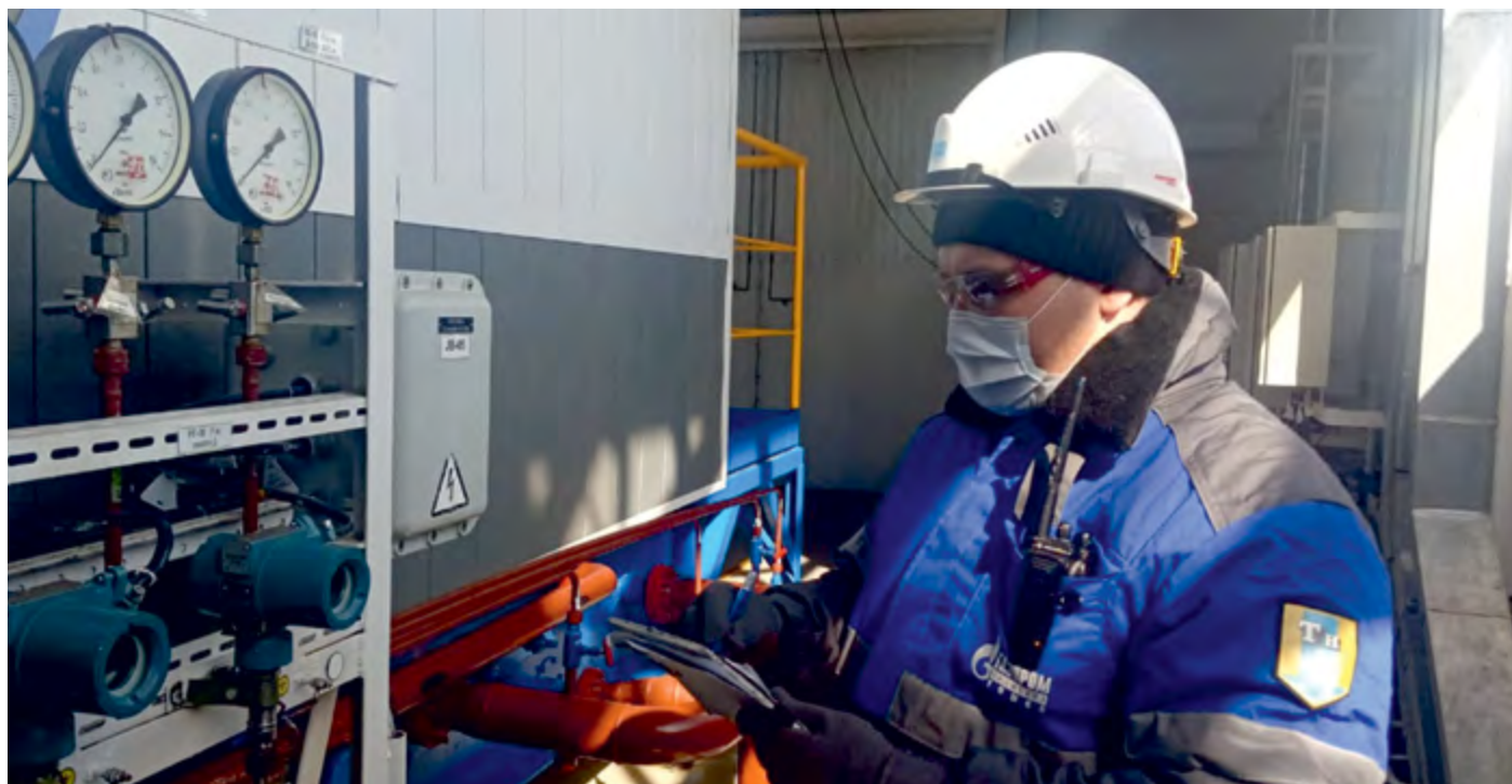
Инженер газоконпрессорной службы Омского ЛПУМГ Андрей Сафронов проводит ежесменный обход, проверяя манометры, основное и вспомогательное оборудование КС «Омская»
