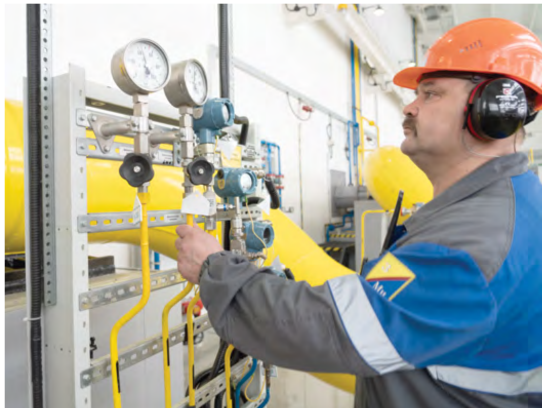
Машинист технологических компрессоров Виктор Боронтов контролирует параметры работы оборудования после запуска
