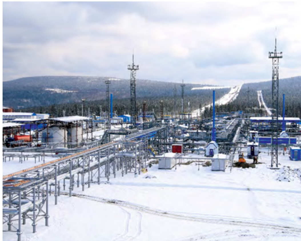
Установка подготовки газа УПГ-102 на Ковыктинском месторождении
